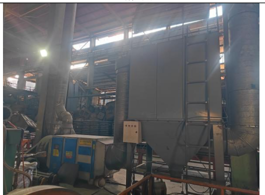
布袋除尘器+有机废气处理装置
